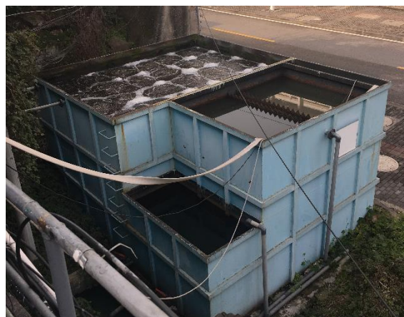
一体化污水处理设施
