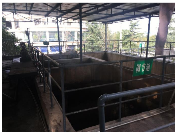
电池总厂生产废水处理站
