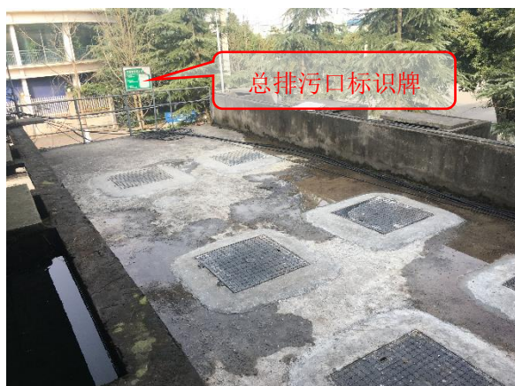
电池总厂生活污水处理站
