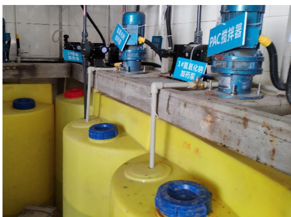
车间污水处理设施加药罐
